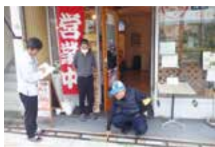
橋通り損傷確認 [8月9日]
