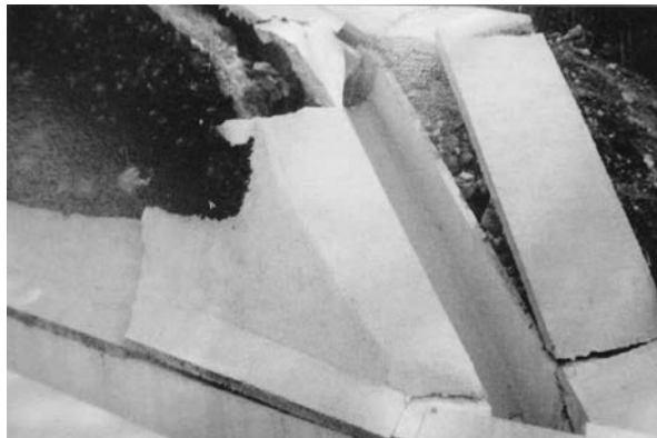
佐伯～蒲江間で生じた地すべりによる亀裂
