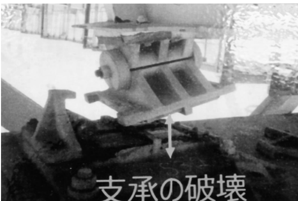
熊本地震では九州道が大きな被害を受けた。
