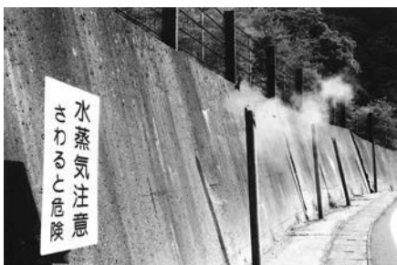
道路わきから吹き出る水蒸気（霧島）
