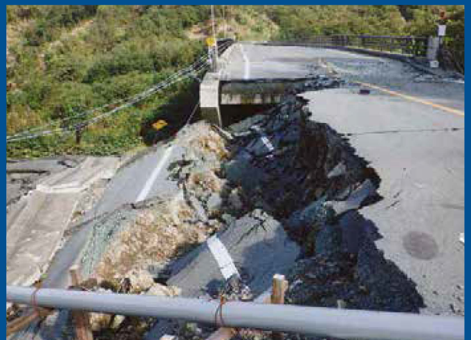
熊本地震で大きく崩れた県道28号と橋梁
