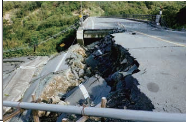
熊本地震で大きく崩れた県道28号
