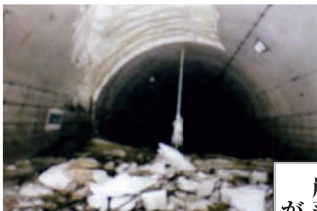
コンクリートが崩れ落ちた俵山トンネル
