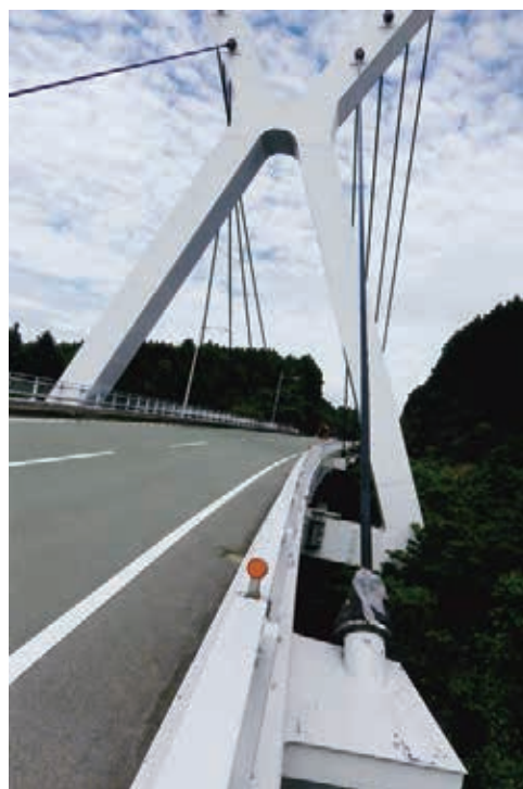
地震動で右にかたむいた桑鶴大橋 ケーブルも損傷
