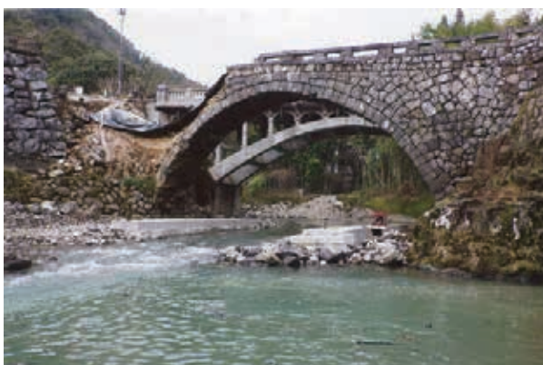
壁石が壊れた二俣福良渡（石橋）
