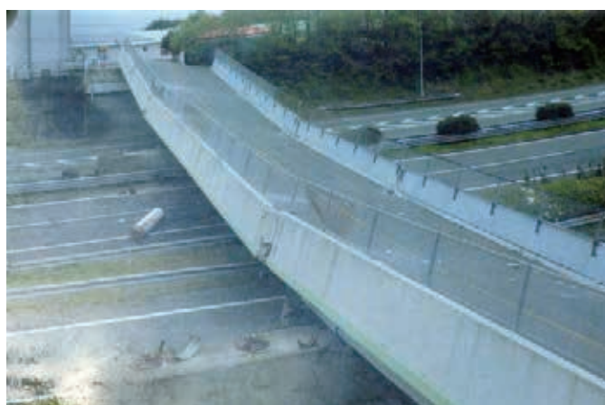
落橋した府領一号橋
