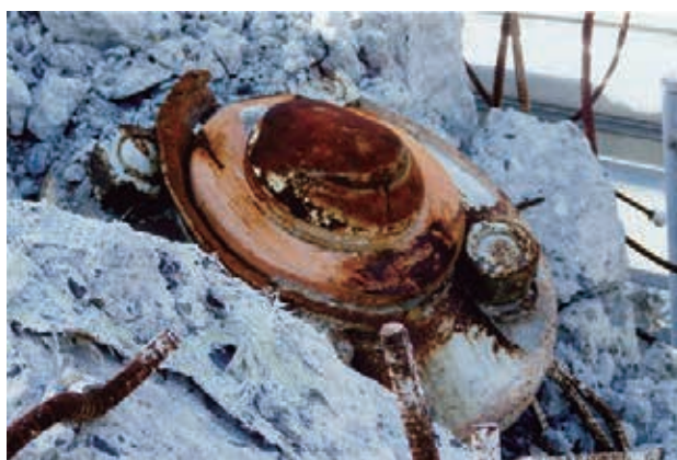
壊れた橋脚の基礎部（九州道・府領橋）
