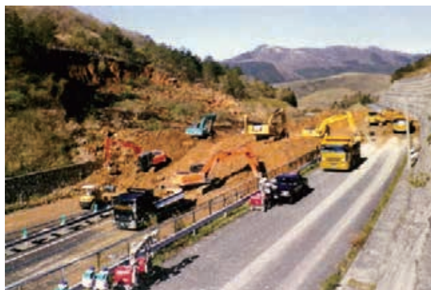
大分道の法面崩壊と復旧工事
