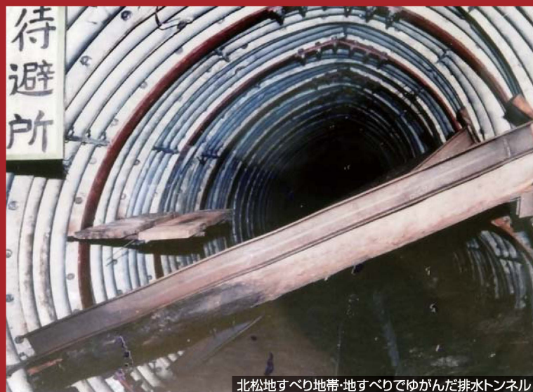
北松地すべり地帯・地すべりでゆがんだ排水トンネル
