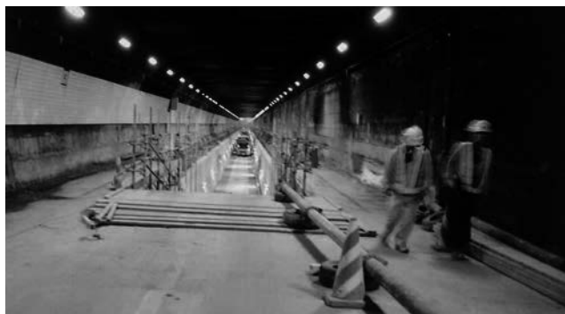
完成から50年を超えても、利用する自動車は1日3万台を大きく超え、床版などの痛みは激しく、点検補修が常に行われている。
